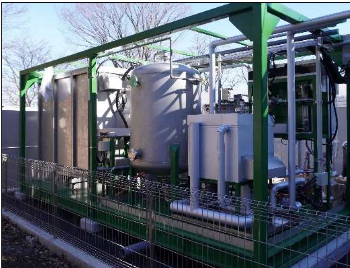
図10 メタン発酵バイオガス発電設備
